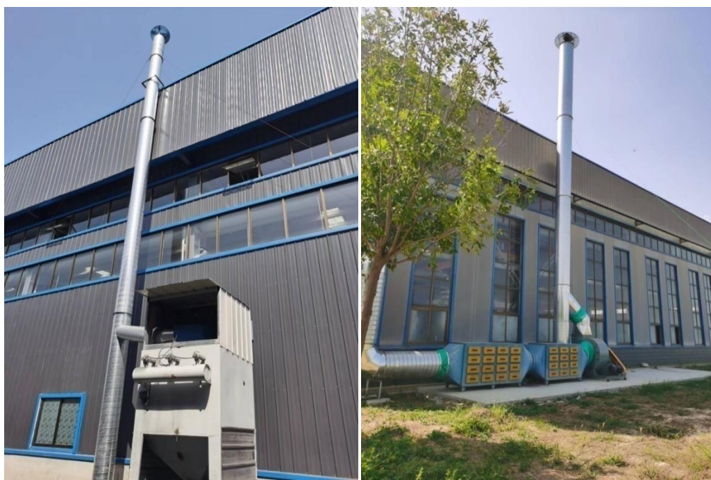
抛丸废气处理设施及排气筒（DA005）喷漆废气处理设施及排气筒（DA006）
