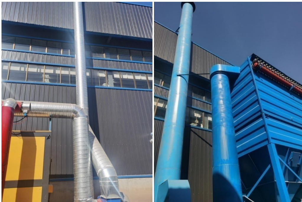
浇注废气处理设施及排气筒（DA003、DA007）
