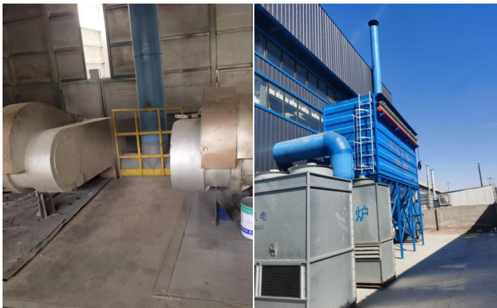
熔化废气处理设施及排气筒（DA001）
